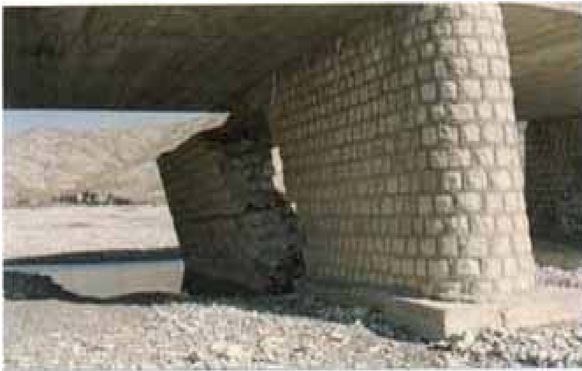
تخریب دیوار میان پایه بر اثر نشست پی
