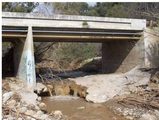
تصویر ۱۰- آبشستگی بستر و زیر فونداسیون پایه ها و کوله ها
