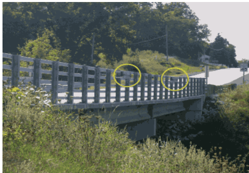
تصویر ۸- شکم دادگی صفحه پل در اثر نشست حفزه ای
