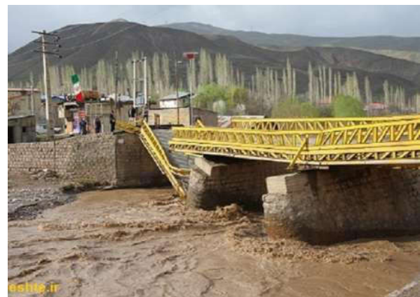
تصویر ۹- انهدام پایه
